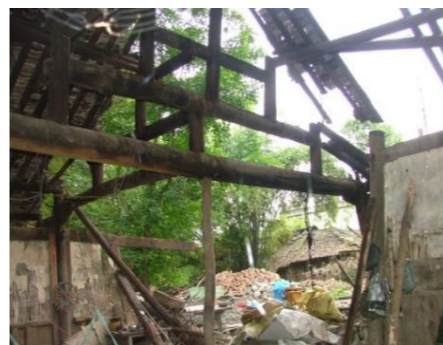
破坏屋盖构件节点连接
