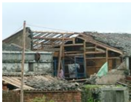
吹落屋面瓦片
