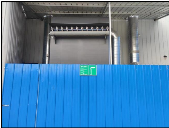
除尘设施 (DA002)
