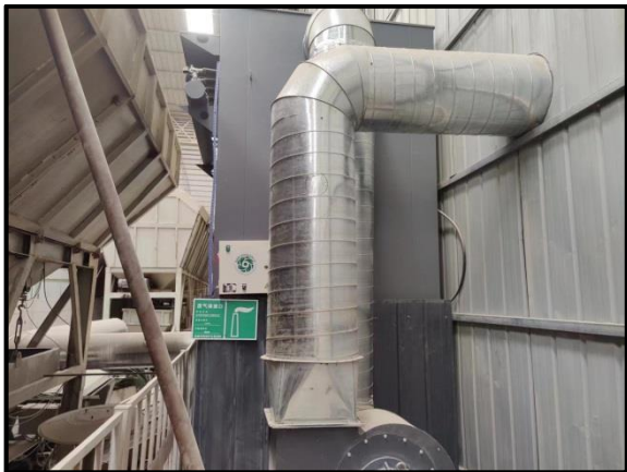
除尘设施 (DA001)
