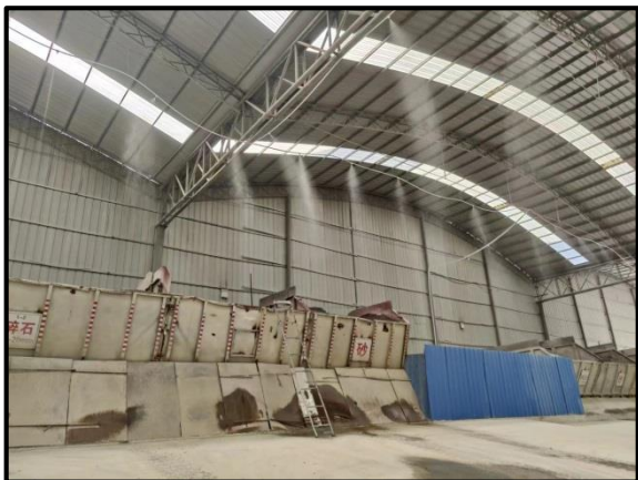
车间喷雾降尘系统
