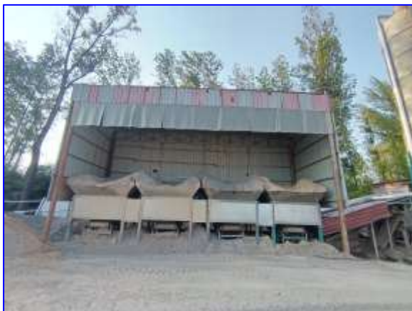
现有水稳料生产线上料斗及集尘罩
