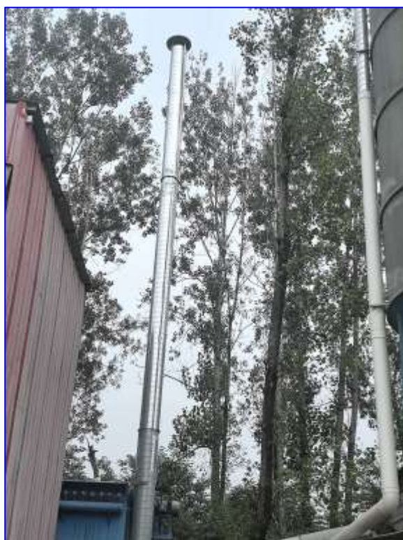
搅拌机除尘器排气筒
