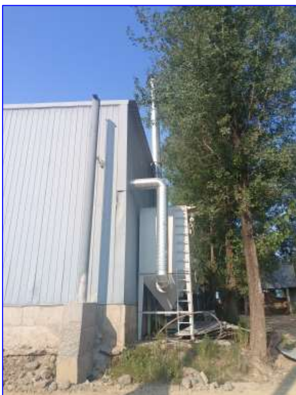
颚破、锥破共用除尘器及排气筒
