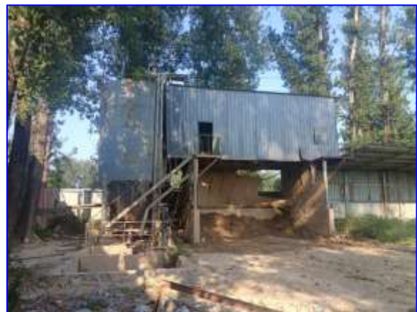
现有废水处理设施及板框压滤机
