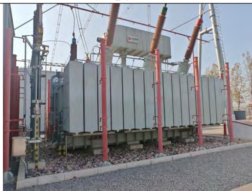
已建 1#主变压器
