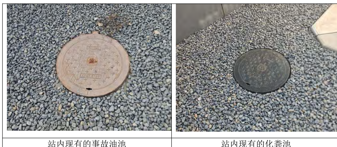
图 2 工程站内环保设施现状
