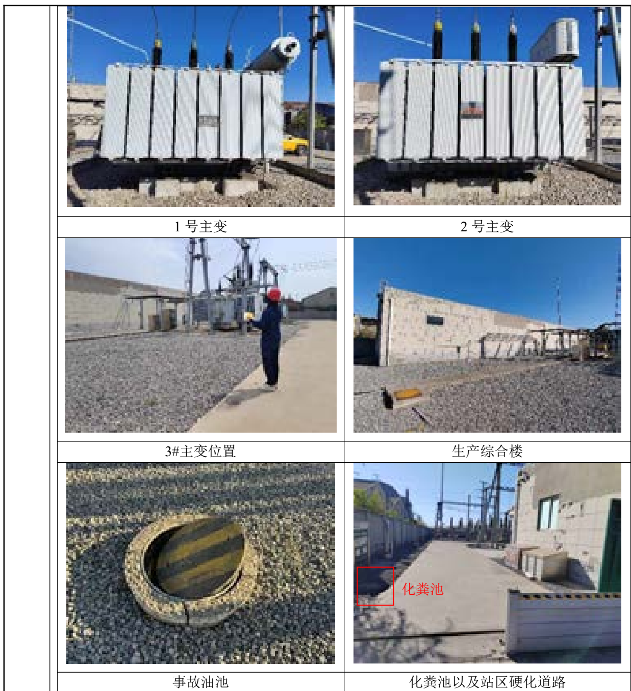
图 2-3 申家泊 110kV 变电站站内现状照片
