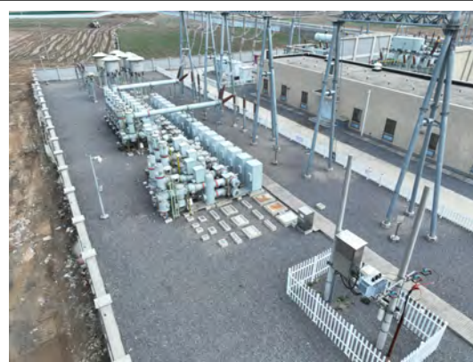
110kV 配电装置区
