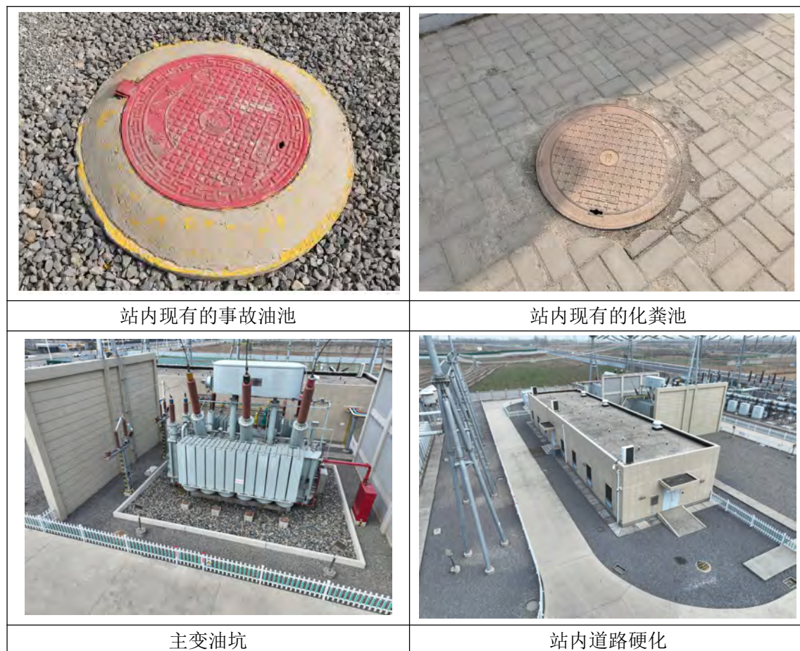
图 2 梦泽 220kV 变电站站内环保设施及措施现状
