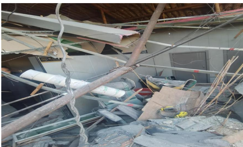
图 5 现场结构失效勘验图
