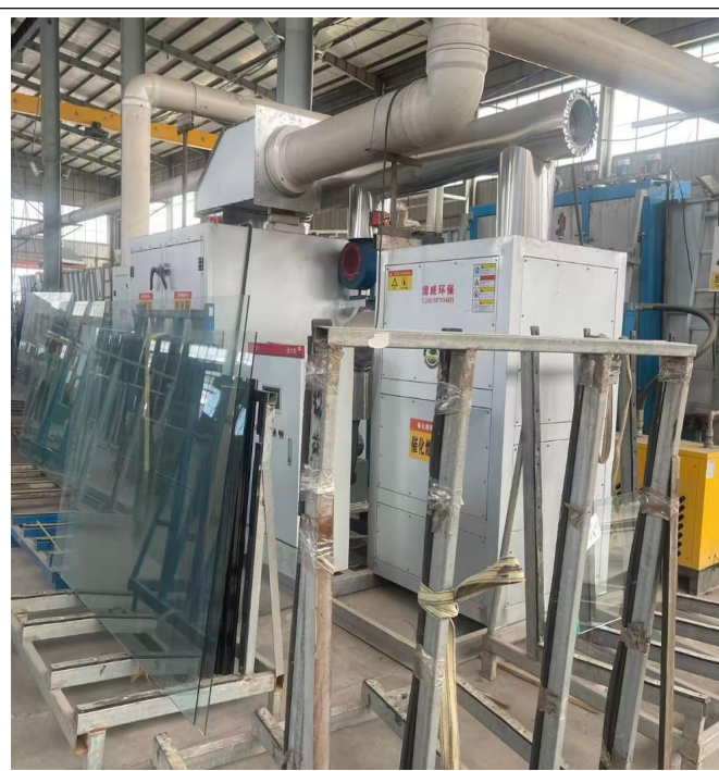
废气处理设施
