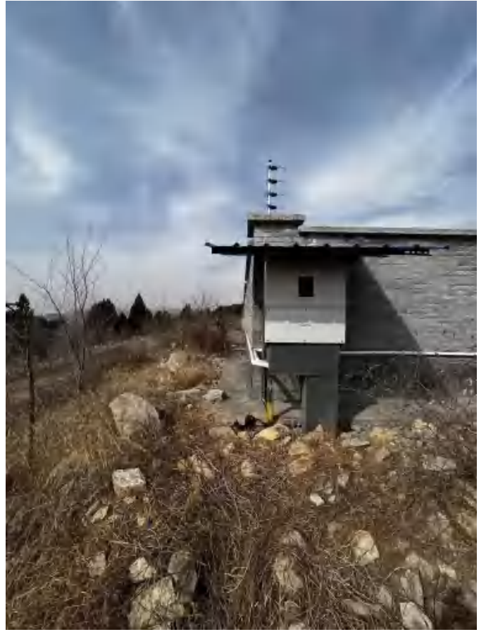
110kV 升压站南厂界
