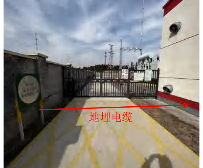
进线地面电缆
