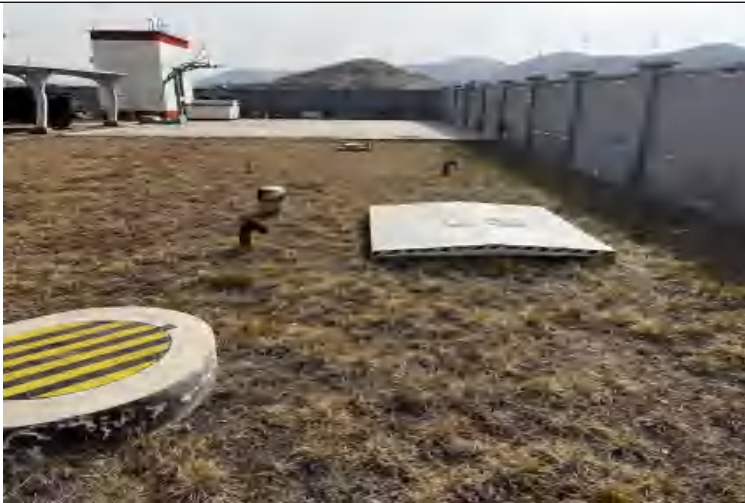
泵箱一体化消防设施
