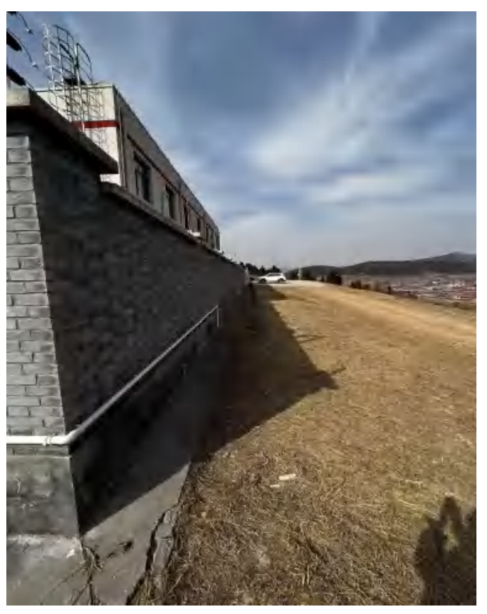
110kV 升压站北厂界
