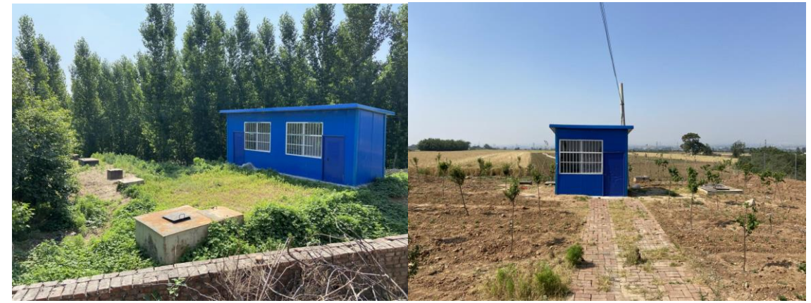
图 2-13 焦坟村污水处理设施
