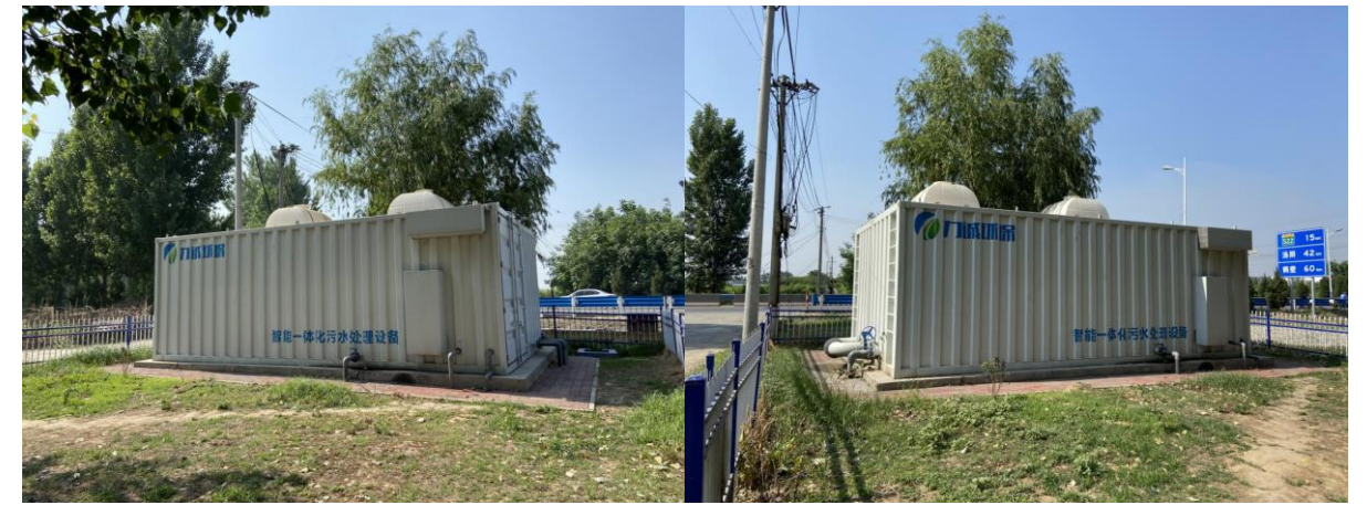
图 2-16 郭王度村污水处理设施
