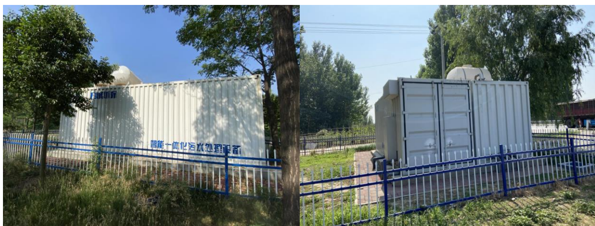
图 2-17 小屯村污水处理设施
