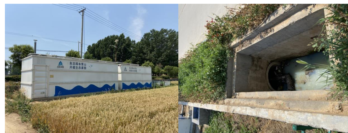
图 2-15 西曲沟村污水处理设施
