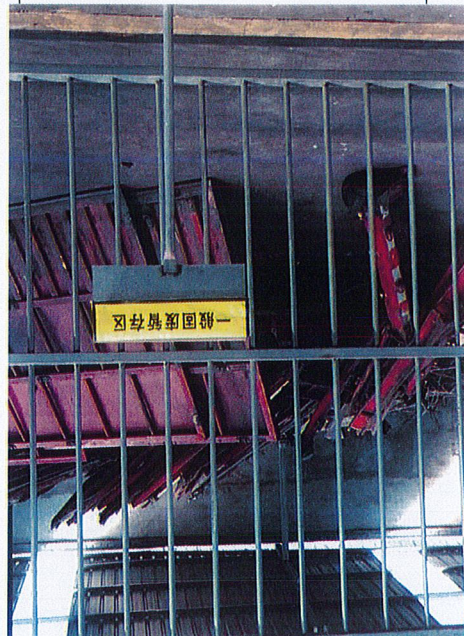
规范一般固废暂存区
