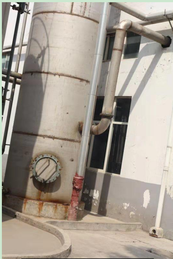
水喷淋装置处设围堰
