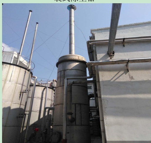
水喷淋装置+15m 高排气筒
