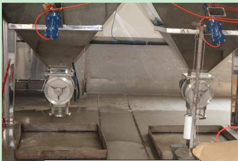
脉冲袋式除尘器灰斗下方设托盘
