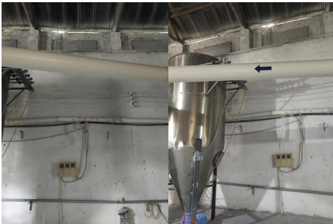
附图四 集气风管走向标识整改前后照片
