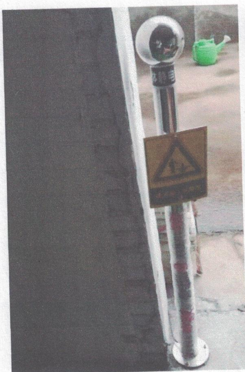
附图 5 静电释放器整改照片
