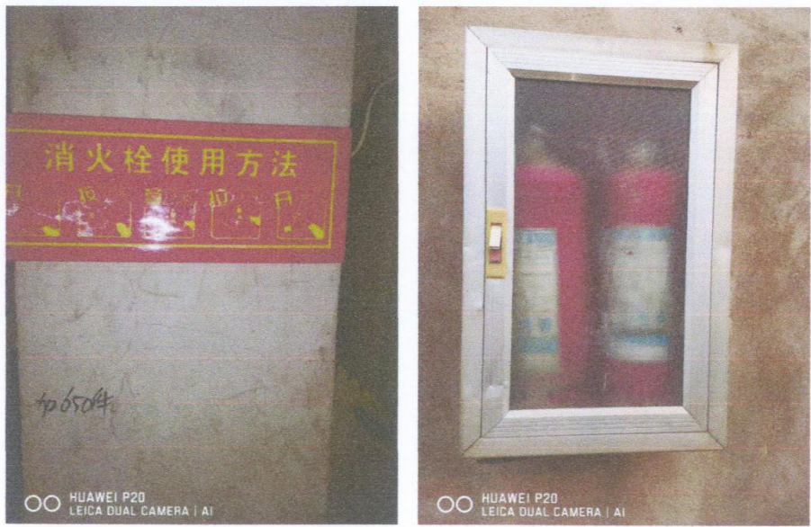
附图 7 消防安全整改照片
