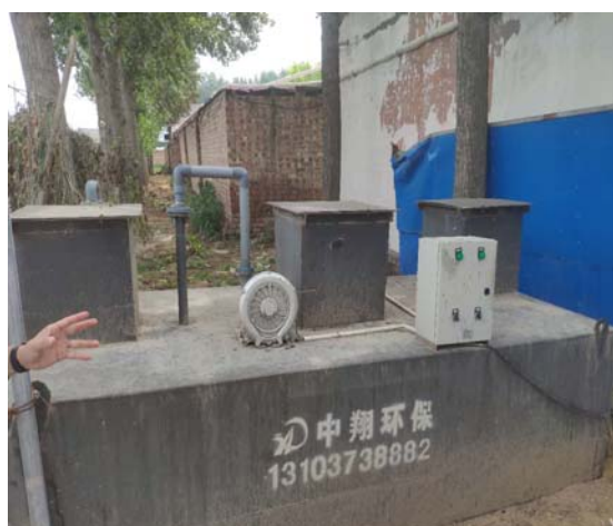
生活污水一体化污水处理设施
