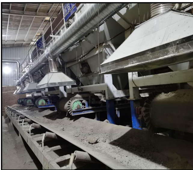
水稳线配料过程集气措施
