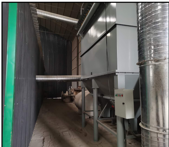
水稳线配料过程除尘器
