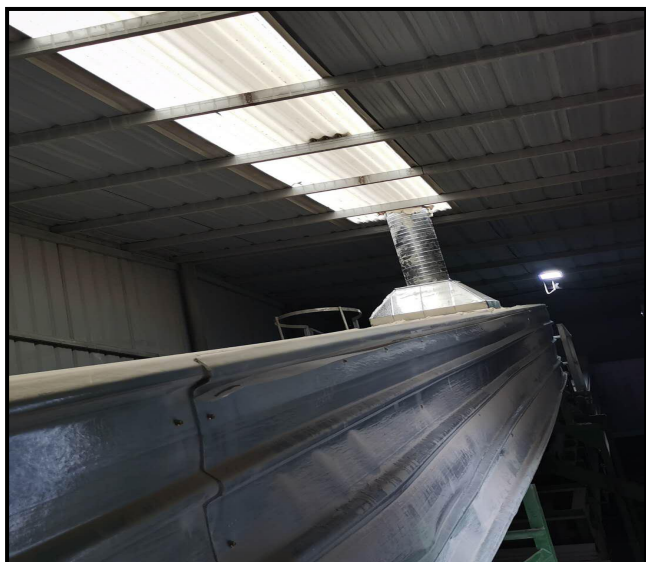
沥青线皮带输送过程粉尘收集措施 1
