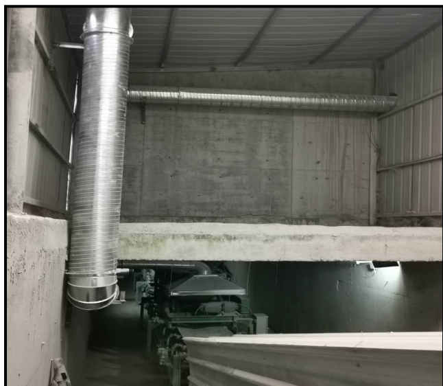
沥青线皮带输送过程粉尘收集措施 2
