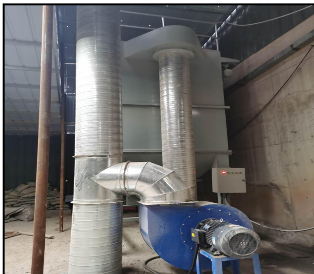
沥青混凝土生产配料过程除尘器
