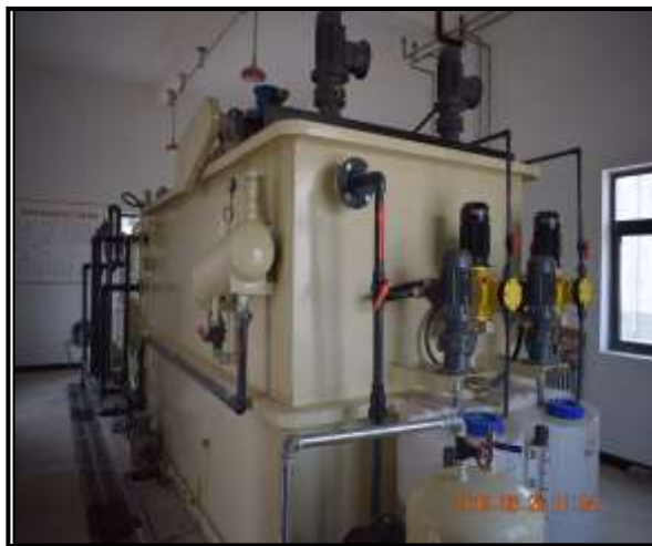
现有含油废水处理设施
