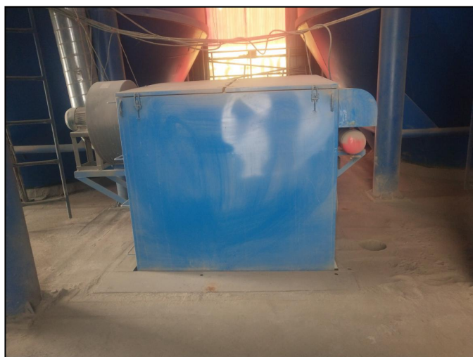
本项目搅拌机除尘器 7#
