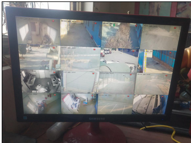
厂区内视频监控系統
