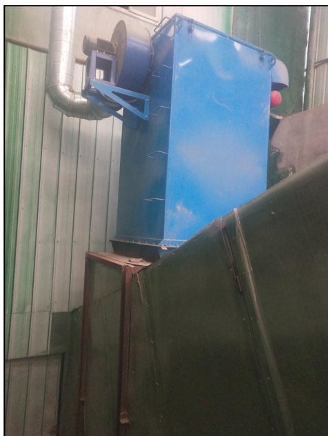
本项目落料及输送除尘器 2#
