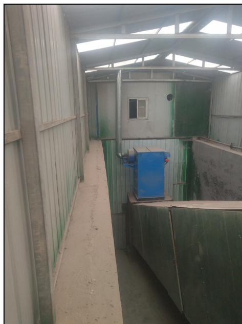
本项目密闭的物料输送廊道
