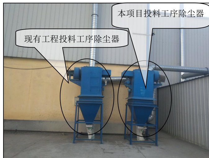
本项目投料工序除尘器 1#
