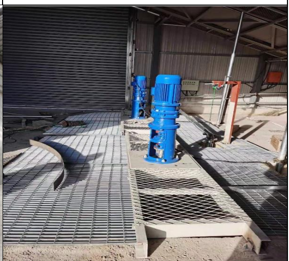
废水处理设施
