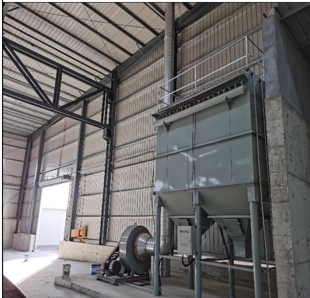
混凝土除尘设施
