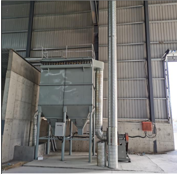
水稳除尘设施
