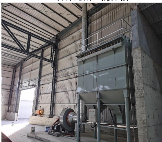
混凝土除尘设施
