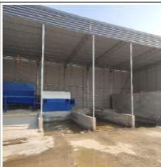
砂石分离机和三级沉淀池
