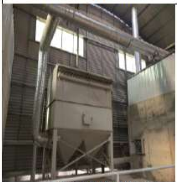
商品混凝土骨料配料除尘器
