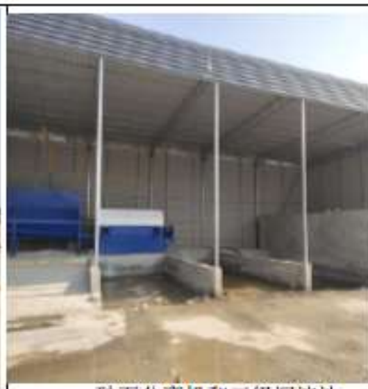
砂石分离机和三级沉淀池
