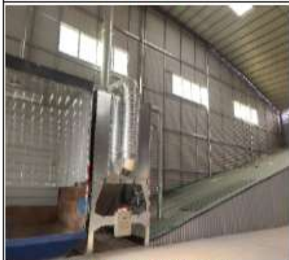
沥青混凝土骨料输送除尘器
