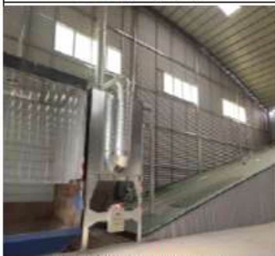
沥青混凝土骨料输送除尘器
