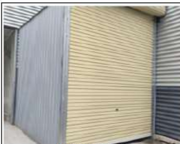
除尘灰出口密闭
