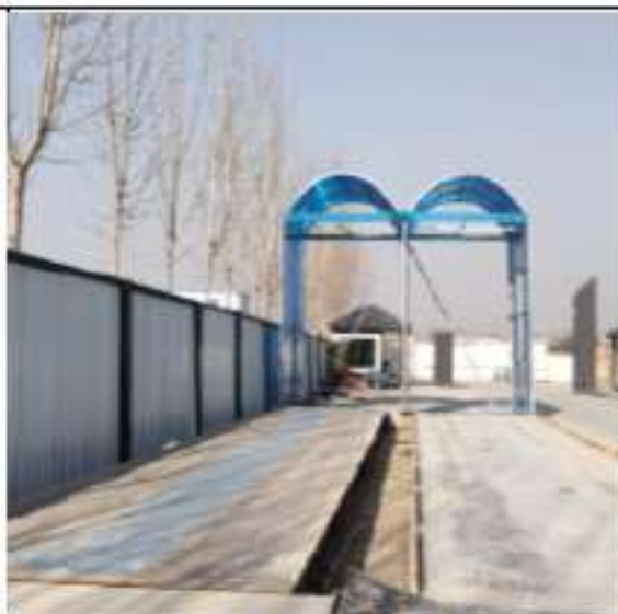
车辆出厂冲洗装置
