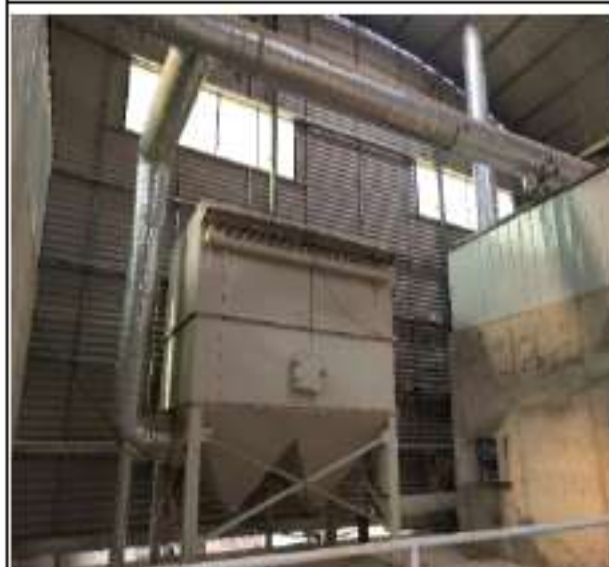
商品混凝土骨料配料除尘器
