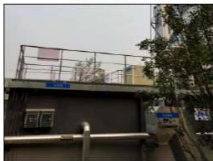
生物医药科技园 B 区污水处理站
