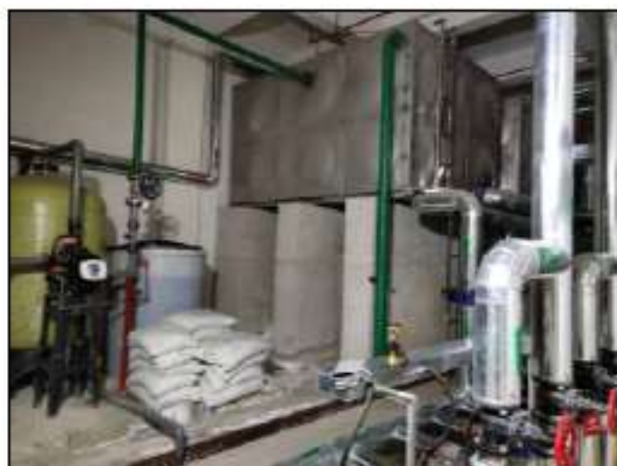
现有软水制备系统
