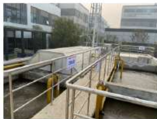
园区污水处理站
