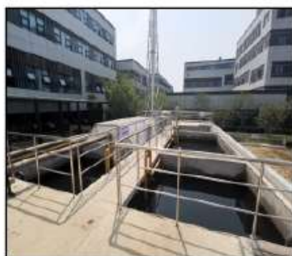
园区污水处理站
