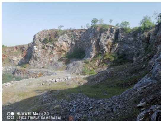
照片 2-22 边坡坍塌
