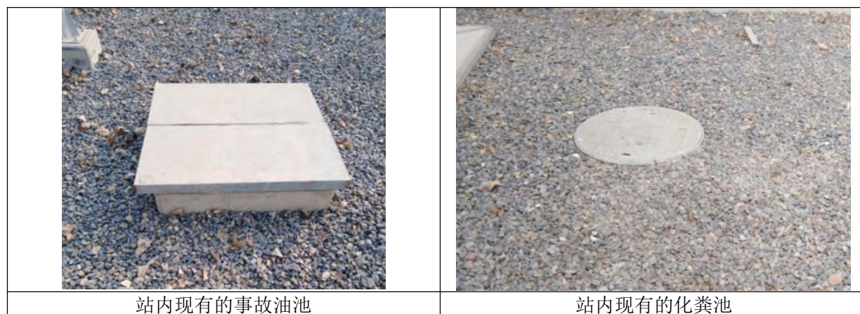
图 2 工程站内环保设施现状
