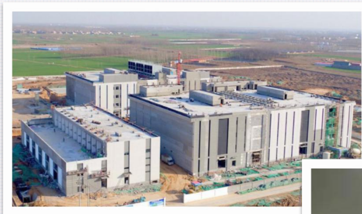
中国移动（河南） 航空港数据中心
